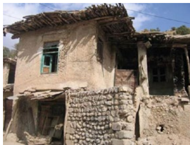
شکل ۹. نمونه‌ای از بناهای دو طبقه در روستای کریک (مأخذ: Cultural Heritage, Handicrafts, and Tourism Organization, 2007)
