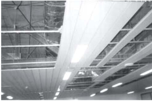
شکل ۹) فرو ریختن پنل های سقف کاذب؛ زلزله ۱۳۸۲ بم [24]
