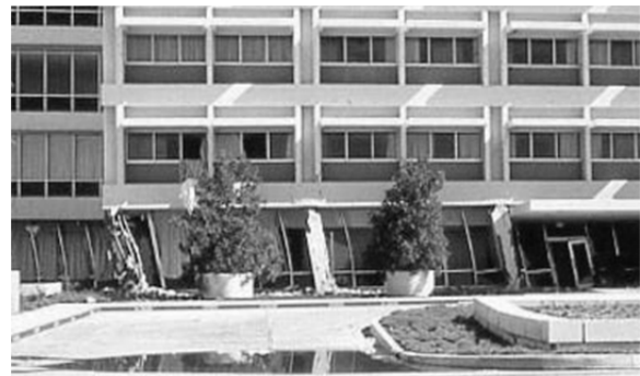
شکل ۲) ایجاد طبقه نرم در بیمارستان الیویو در زلزله ۱۹۷۱ سان‌فرانسیسکو در اثر حذف دیوارهای برشی طبقه همکف [1]
